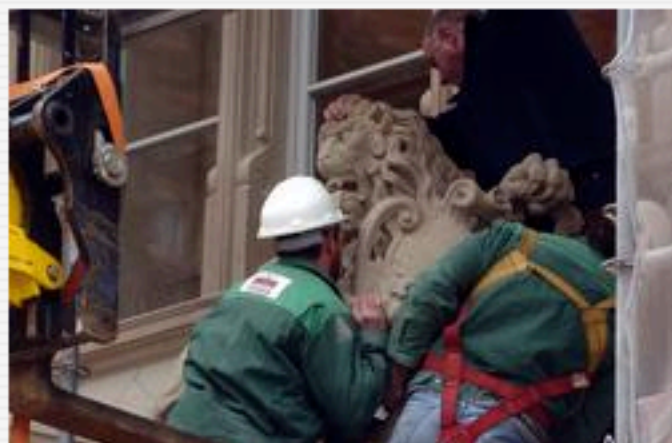
L'un des lions de la façade de la CCI est en train de retrouver sa place. (Photo DNA - Cédric Joubert)
